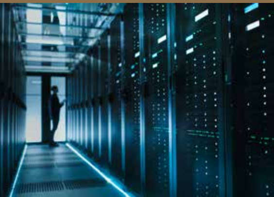
Anlagen für Rechenzentren | Equipment for data centers
