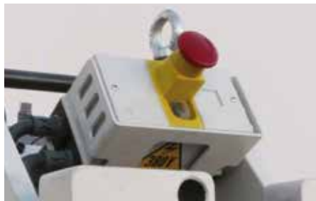
Caja eléctrica con bobina y guardamotor. Electric box with motorguard and coil.
